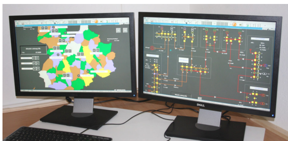
Arbeitsplatz zur Netzsteuerung
