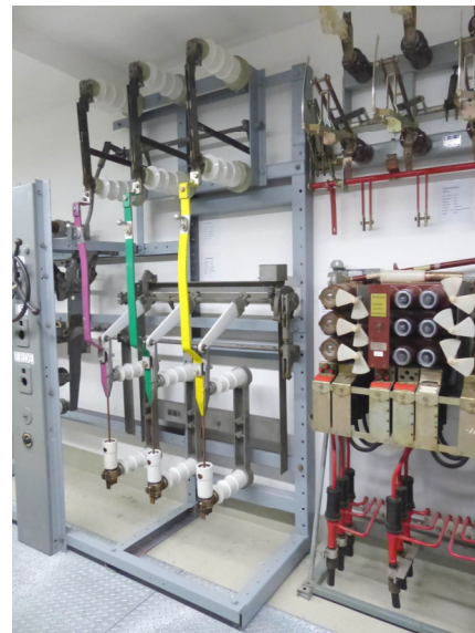
Offener Lasttrennschalter (li.) und ISOPONT-Verteilung (re.)
