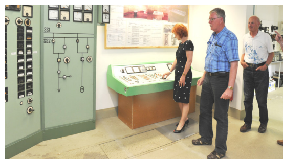
Besichtigung neue Schaltwarte in Markkleeberg
