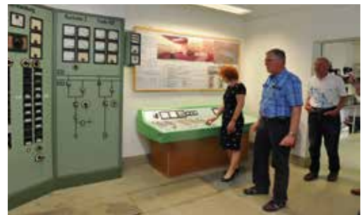
■ Besichtigung neue Schaltwarte
