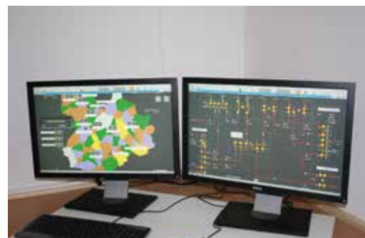
■ Arbeitsplatz zur Netzsteuerung
